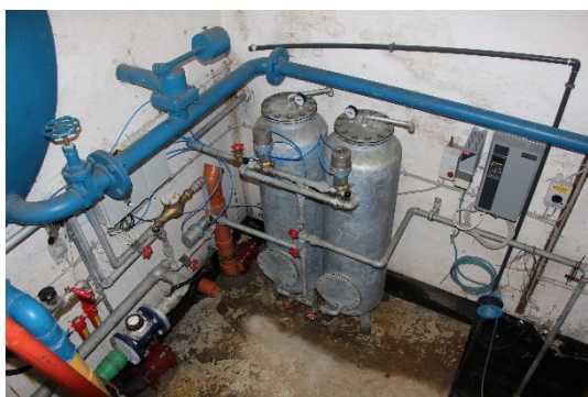
Trykfiltre i vandværksbygning.
