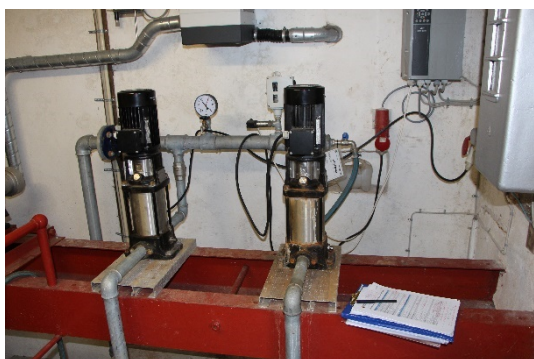
Rentvandspumper på vandværket.
